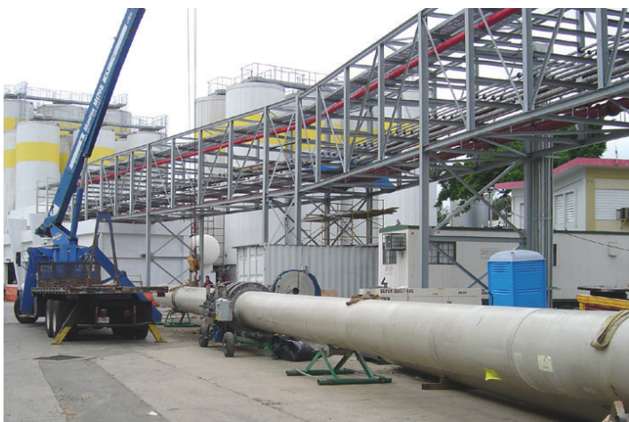
Transporte de químicos en tubería de gran diámetro de PP Proline® de Asahi/America.
