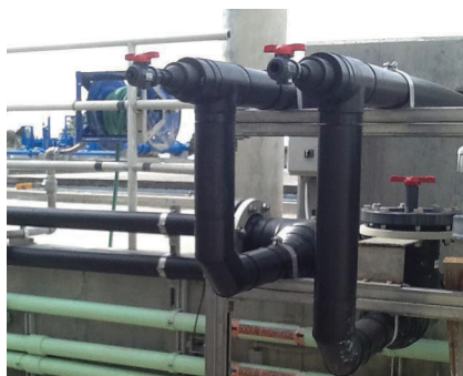
Transporte seguro de blanqueador con el Sistema de PE avanzado Chem Proline® de Asahi/America.
